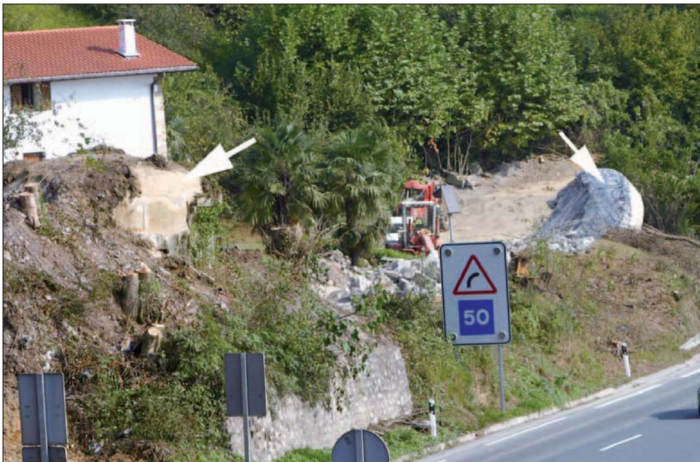
Fig. 25: Gaintxurizketa: Obra n. 4 durante la demolición. Puede apreciarse su situación con relación a la carretera N-I y al caserío "Kamio-txiki".
